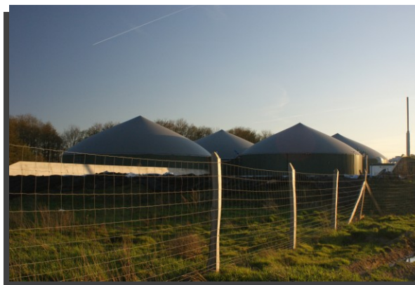
Gärbehälter einer 500Kw-Anlage südlich von Lübeck
